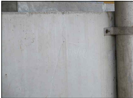
교각 기둥 균열(P1)
