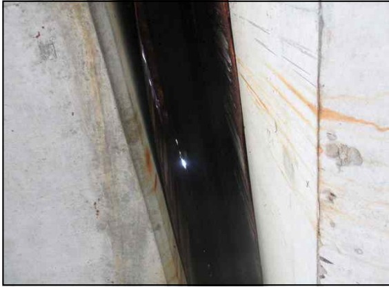
신축이음 본체 고무재 파손(A1)
