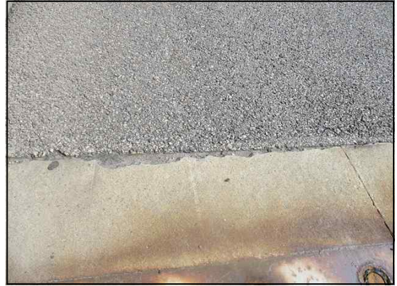
신축이음 후타재 파손(A1)
