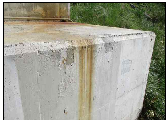
교대 콘크리트 표면열화(A2)
