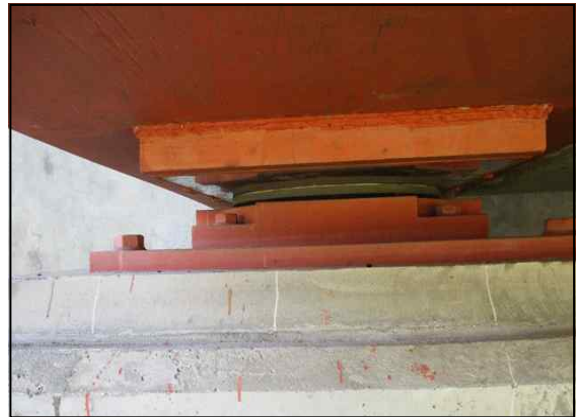
받침콘크리트 균열(A2 SH1)
