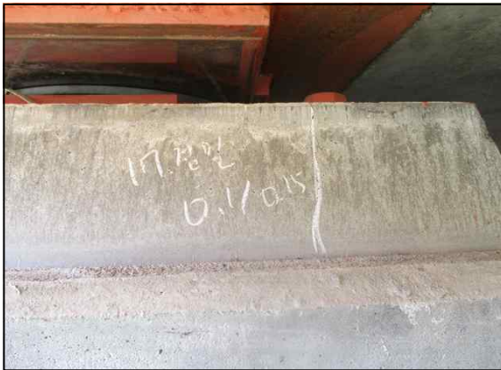
받침콘크리트 균열(A1 SH1)
