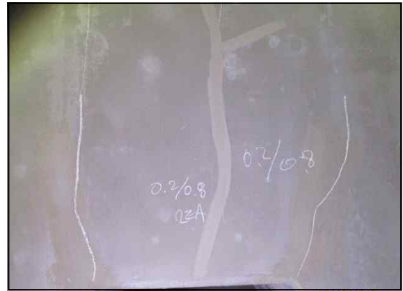
거더 내부 격벽 균열(S3)
