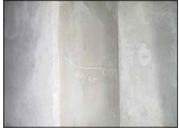
거더 내부 정착구 균열(S2)
