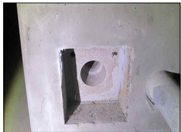
거더 내부 정착구 부식(S8)
