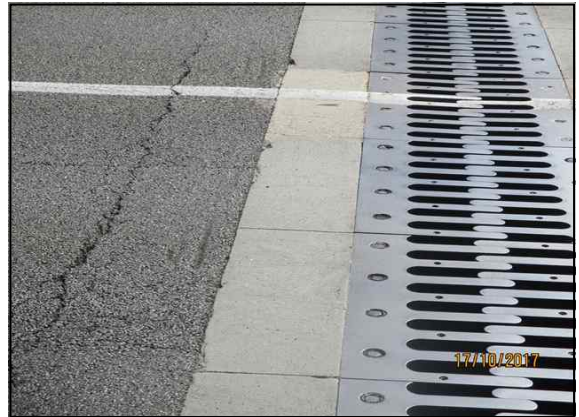
신축이음 후타재 균열(A2)
