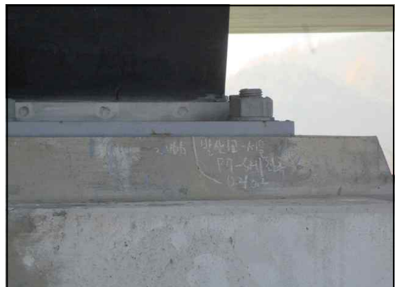
받침콘크리트 균열(P7 SH1)
