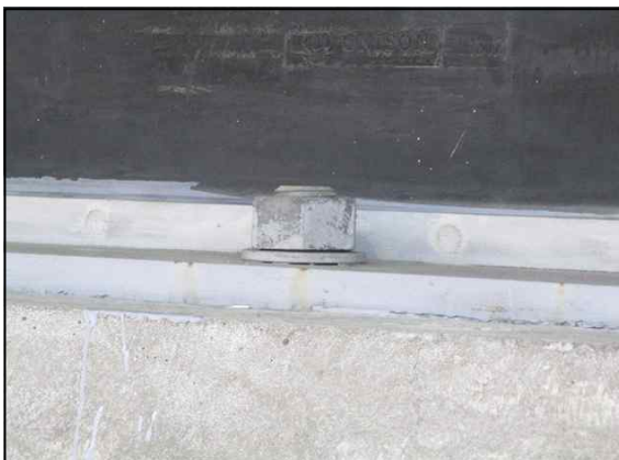
교량받침 볼트 체결불량(P6 SH1)
