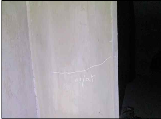
거더 내부 정착구 균열(S2)
